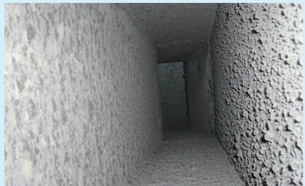
ダクト内部の汚れ(塵埃)
