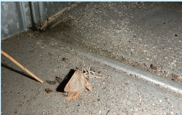
ダクト内部の汚れ(虫の死骸)
