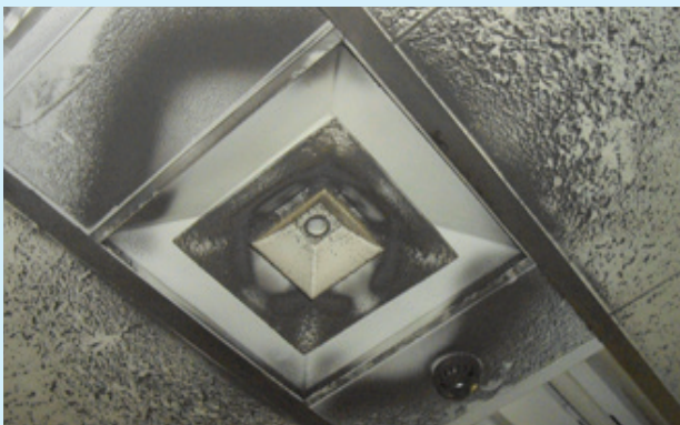
空調吹出口周辺に付着した粉塵
