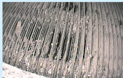
空調機本体 フィンの汚れ
