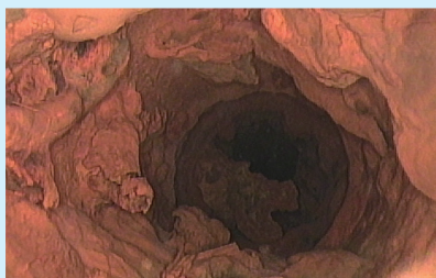
給水管 錆コブによる閉塞
