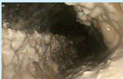
排水管 油脂の付着
