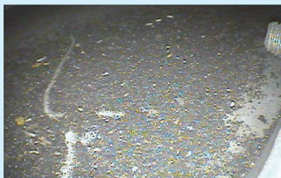
給気ダクト 粉塵の堆積
