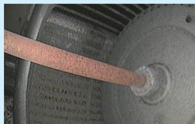
空調機本体 シャフトの錆
