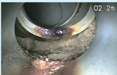
排水管 配管の破損
