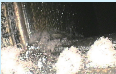
排気ダクト 油汚れ・綿埃の付着
