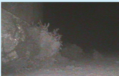
給気ダクト 劣化した内張材の堆積
