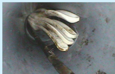
排水管 異物による詰まり
