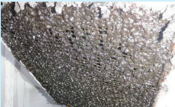
目詰まりした排気吹出口
