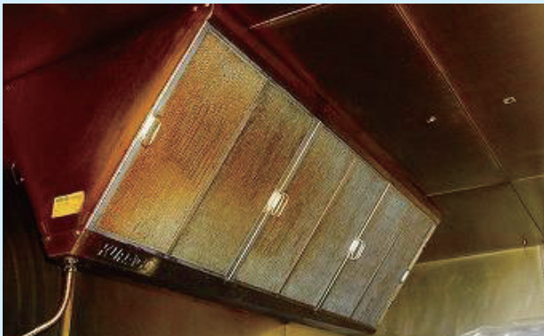
フード内の油汚れ
