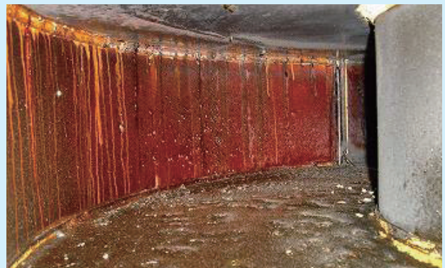
排気ダクト内の油汚れ
